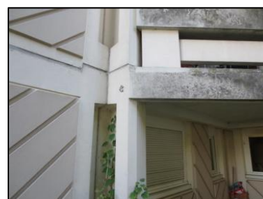
Photo N° 35 ECH-N°96 1 - Balcon Poteau Béton + peinture
