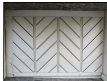
Photo N° 3 ECH-N°67 32-Porche RUE Mur hachuré Béton + peinture
