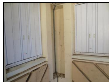
Photo N° 51 ECH-N°112 3 - Balcon +4 Murs Béton + peinture beige
