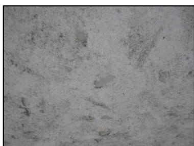
Photo N° 2787 ECH-N°64 FLOCAGE 5-Porche Plafond
