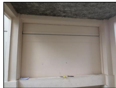
Photo N° 12 ECH-N°76 32 - Porche 30-32 Mur droite Béton + peinture
