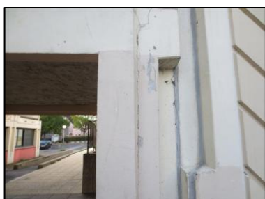
Photo N° 59 ECH-N°119 5 - Façade Béton + peinture beige
