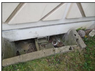
Photo N° 2722 ECH-N°30 AMIANTE CIMENT 7--Façade 2 Conduits accès vide sanitaire Ventilation (Fibres-ciment)
