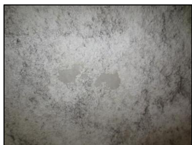
Photo N° 2784 ECH-N°61 FLOCAGE 21-Préau Plafond
