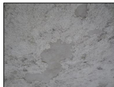
Photo N° 2786 ECH-N°63 FLOCAGE 30-Préau Plafond
