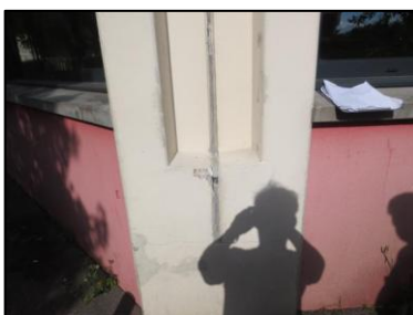
Photo N° 37 ECH-N°98 3 - Façade Mur Joint de dilatation mousse + mastic
