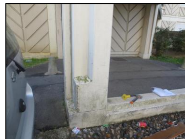
Photo N° 2 ECH-N°66 32-Porche RUE Mur façade Béton + peinture beige
