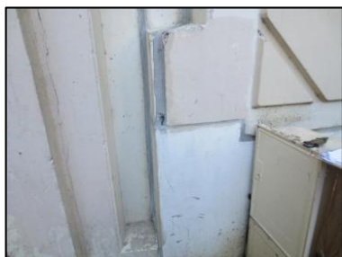
Photo N° 61 ECH-N°121 5 - Façade Mur Joint de dilatation mousse + mastic
