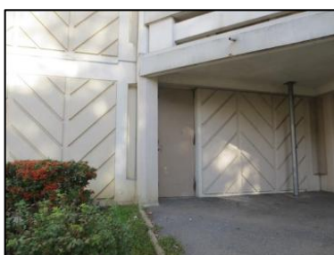
Photo N° 68 ECH-N°128 5 - Balcon Poteau Béton + peinture
