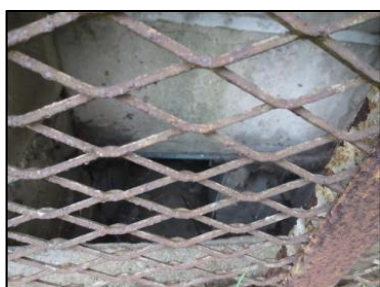
Photo N° 2730 ECH-N°30 AMIANTE CIMENT 32--Façade Conduits accès vide sanitaire Ventilation (Fibres-ciment)
