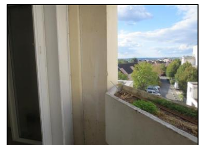
Photo N° 49 ECH-N°110 3 - Balcon +4 Poteau Béton + peinture beige
