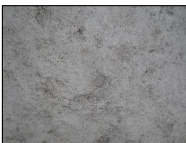
Photo N° 2788 ECH-N°65 FLOCAGE 3-Porche Plafond
