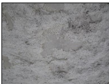
Photo N° 2785 ECH-N°62 FLOCAGE 28-Préau Plafond
