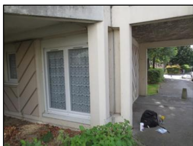
Photo N° 26 ECH-N°88 28 - Balcon Poteau Béton + peinture beige
