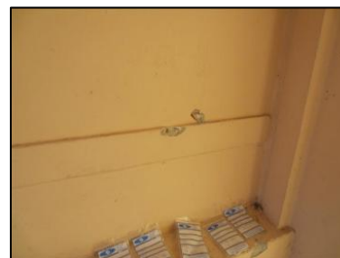
Photo N° 63 ECH-N°123 5 - Porche 3 / 5 Mur - Retour dalle Béton + peinture
