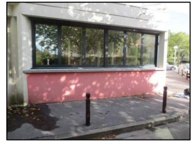
Photo N° 40 ECH-N°101 3 - Façade Mur sous fenêtre Enduit rose
