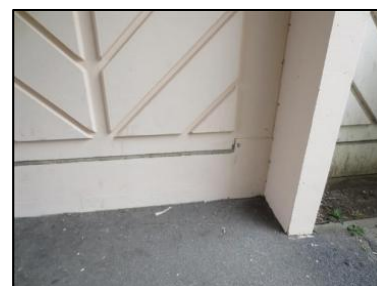
Photo N° 77 ECH-N°137 19 - Porche 19-21 Mur – Joint fondation Mastic
